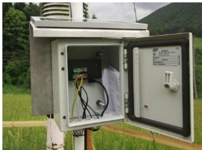
Slika 46: Omarica s sončno celico, Li-Ion baterijo, anteno, GPRS modemom in hranilnikom podatkov. (Foto: Iztok Sinjur)
